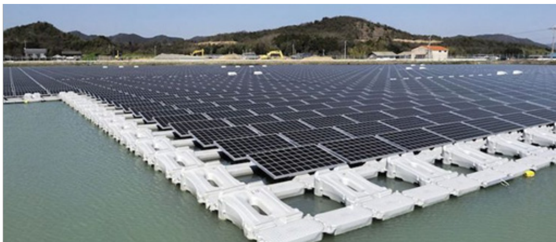
Imagen 5: Planta fotovoltaica en el embalse de Sierra Brava (Cáceres)
